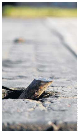
Spowalniacze, składające się z wielu elementów montowanych na śruby, są często kłopotliwe
