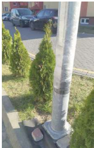
Prowizorycznie zabezpieczona latarnia, która zdaniem mieszkańców osiedla może stanowić zagrożenie dla dzieci
