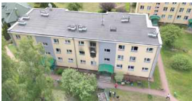
Na szczęście wybuch nie naruszył konstrukcji budynku
