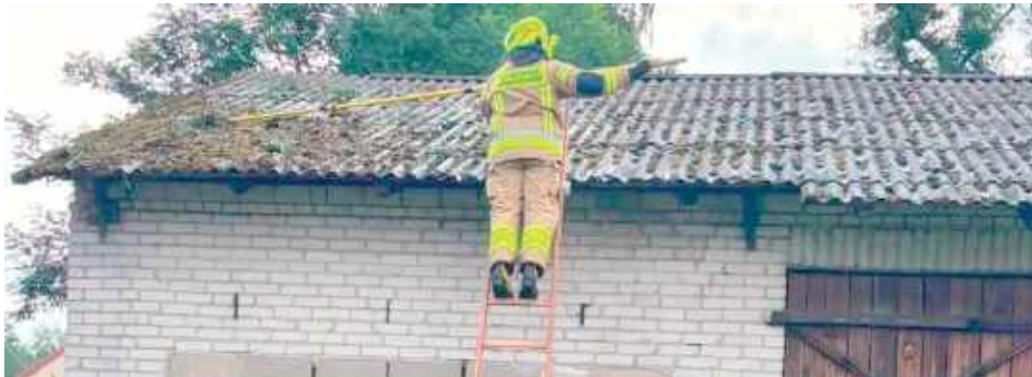
Strażacy interweniowali przede wszystkim w Stężycy, gdzie usuwali konary z dróg, chodników i budynków, a także zabezpieczali drzewa zagrażające liniom energetycznym
