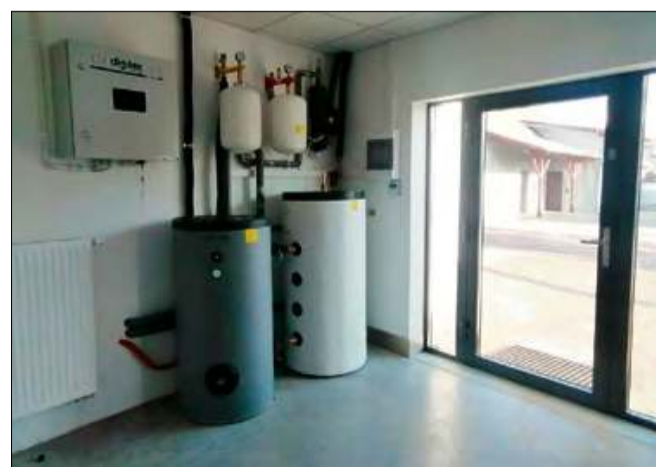
W budynku zamontowano nowoczesne instalacje: grzewczą, ciepłej wody użytkowej oraz system pomp ciepła.
