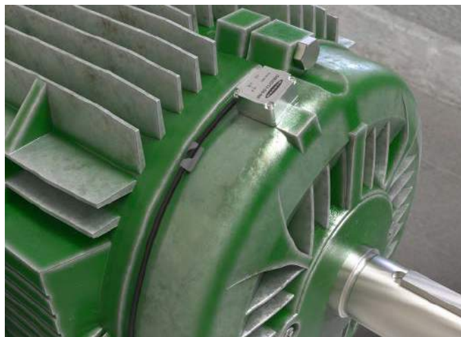
Fotografia 1. Czujnik drgań zamontowany na korpusie silnika
