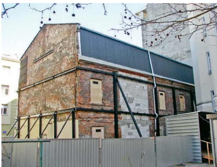
Zabezpieczona kamienica przy Poznańskiej 21 – widok od strony podwórza | fot. Janusz Sujecki/Gazeta Polska
