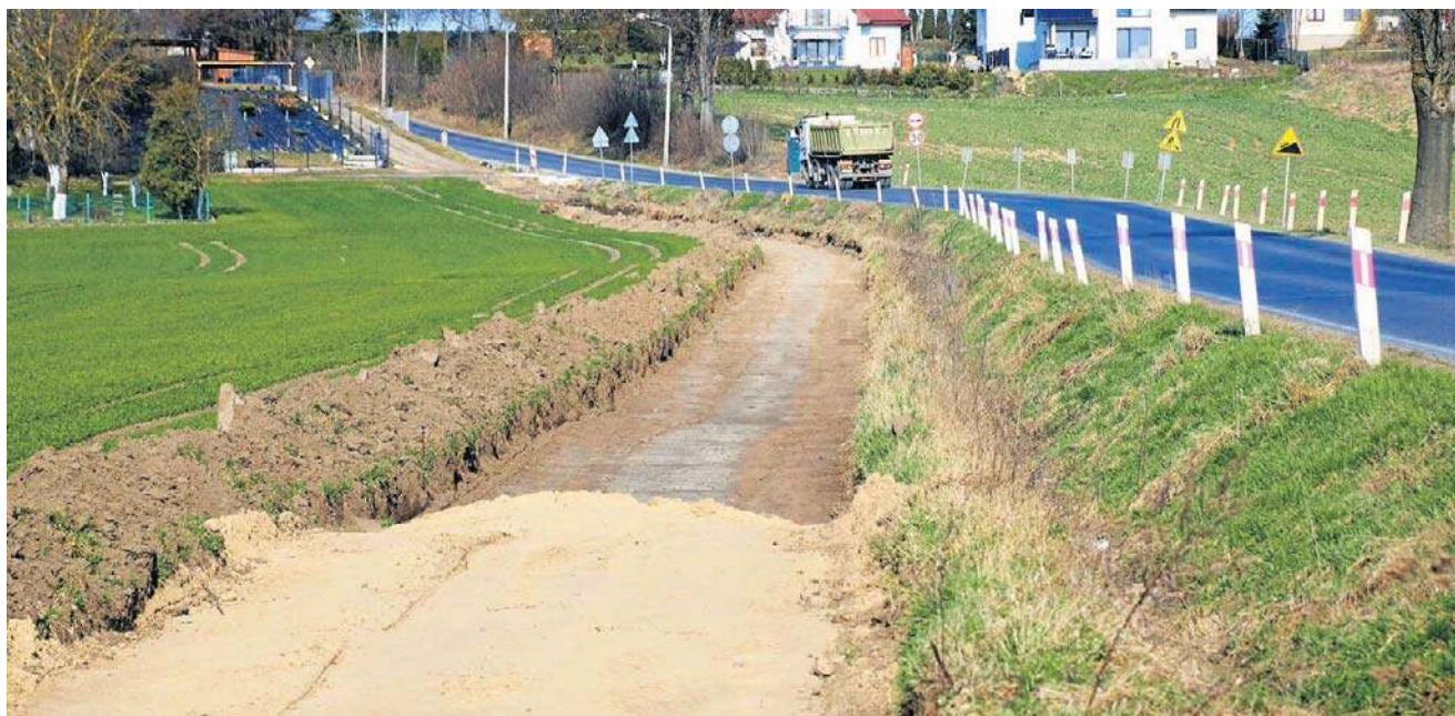
Na drodze rowerowej powstającej na odcinku Młyniec - Brzezinko można na własne oczy obserwować postęp prac budowlanych
