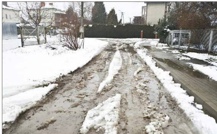
Tak wygląda ul. Osiedlowa po roztopach i opadach deszczu. A wszystko to ok. 600 metrów w linii prostej od dębickiego Rynku.
