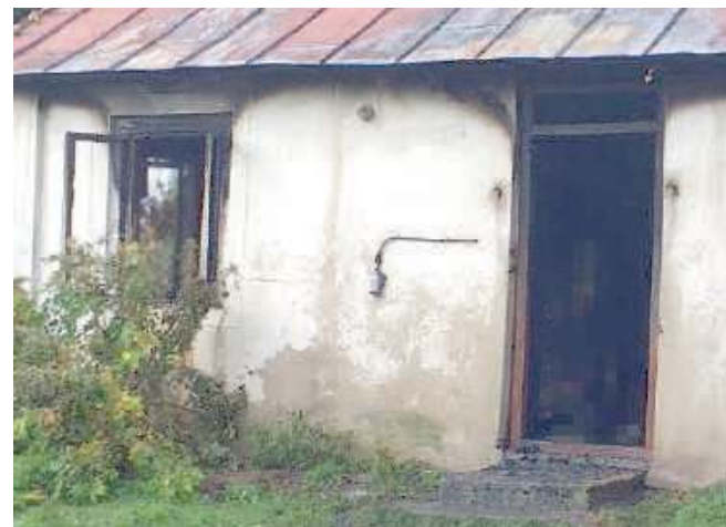
Dom uległ częściowemu spaleni
