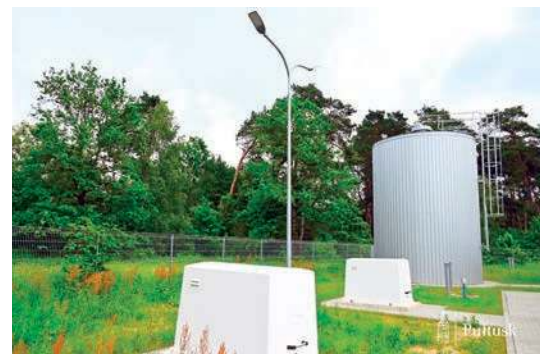
Stacja uzdatniania wody
