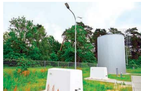
Stacja uzdatniania wody
