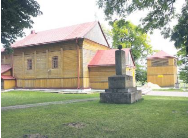
Kościół w Dubie potrzebuje remontu.
