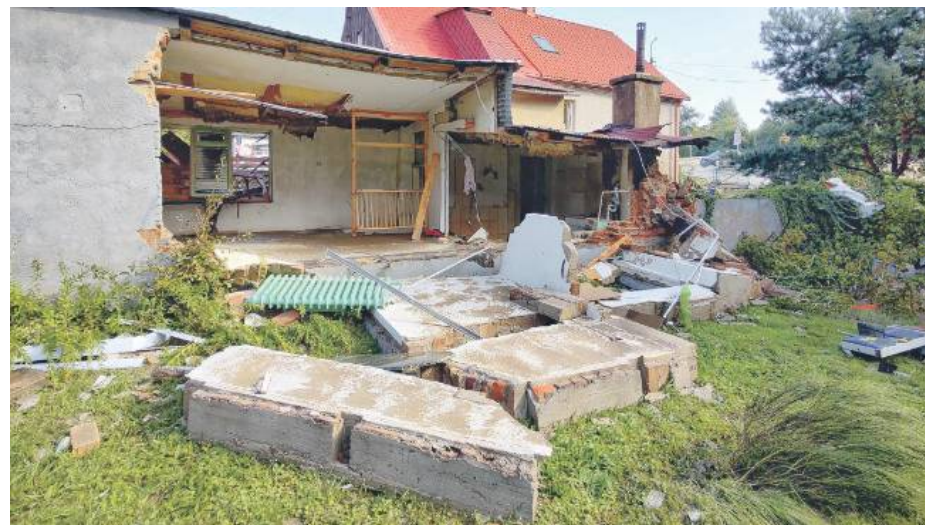
Największe szkody odniosła część budynku, w której znajdowała się galeria rzeźb i pracownia. Pomieszczenia te wymagają rozbiórki i odbudowy od podstaw
