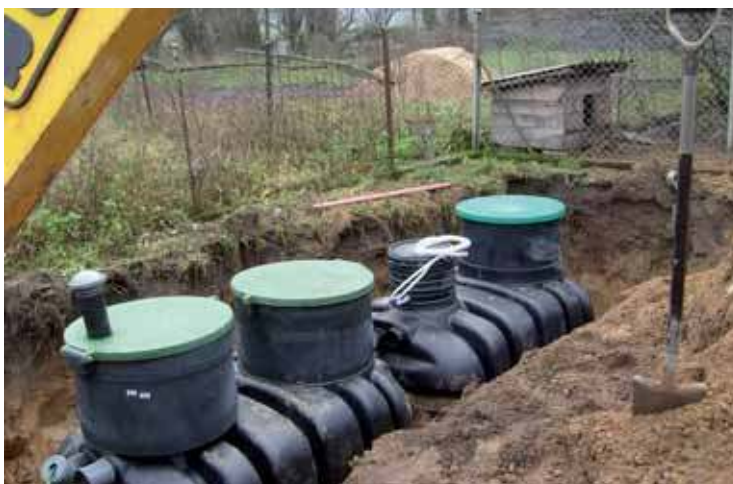
Przydomowe oczyszczalnie, gm. Dzierżążnia
