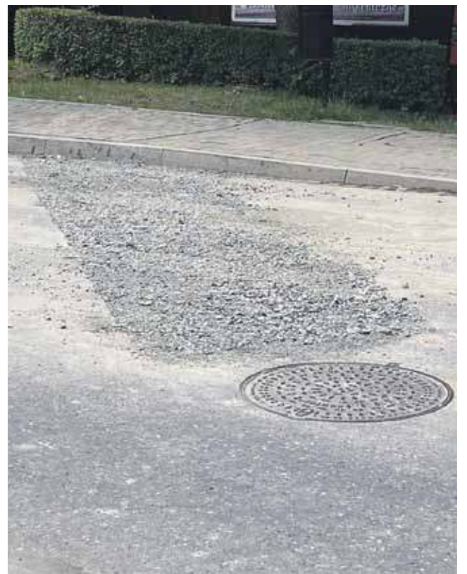
Nowy asfalt, a już rozkopany.
