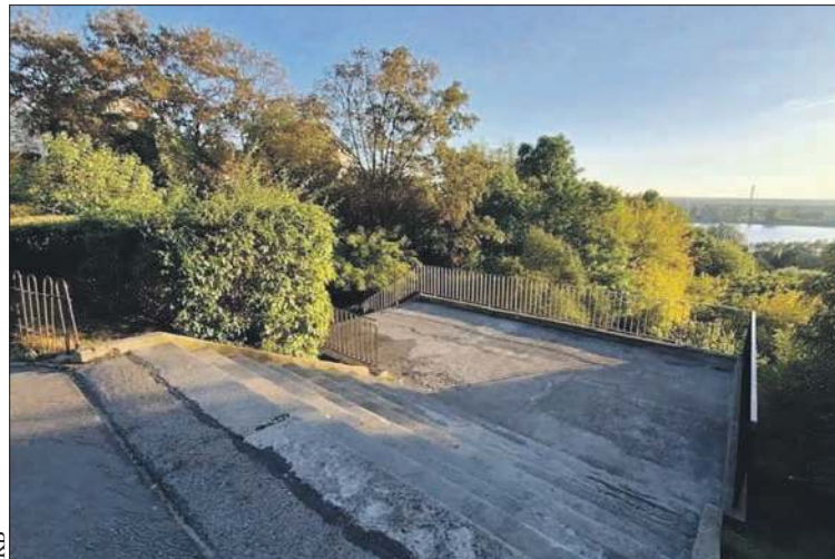
W płockim ratuszu chcą dysponować dokumentacją geologiczną zanim podejmą decyzję, co dalej ze schodami prowadzącymi na nabrzeże
