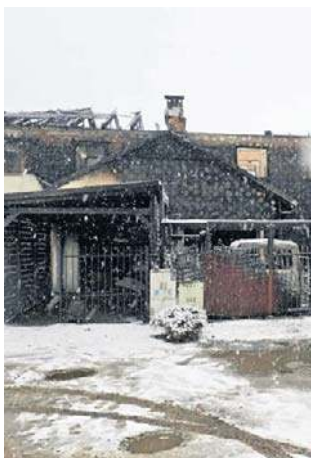
Zniszczenia po pożarze są ogromne
