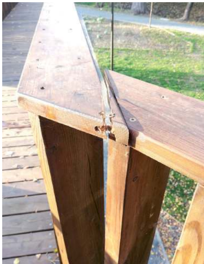
9 października, mimo że barierka (5 metrów nad ziemią) nie została naprawiona, ludzie wchodzili na kładkę, bo ktoś rozerwał taśmę zagrażającą wejściu. Przedstawiciel Straży Miejskiej, do którego zadzwoniliśmy, nie wiedział, czy kładka powinna być zamknięta
