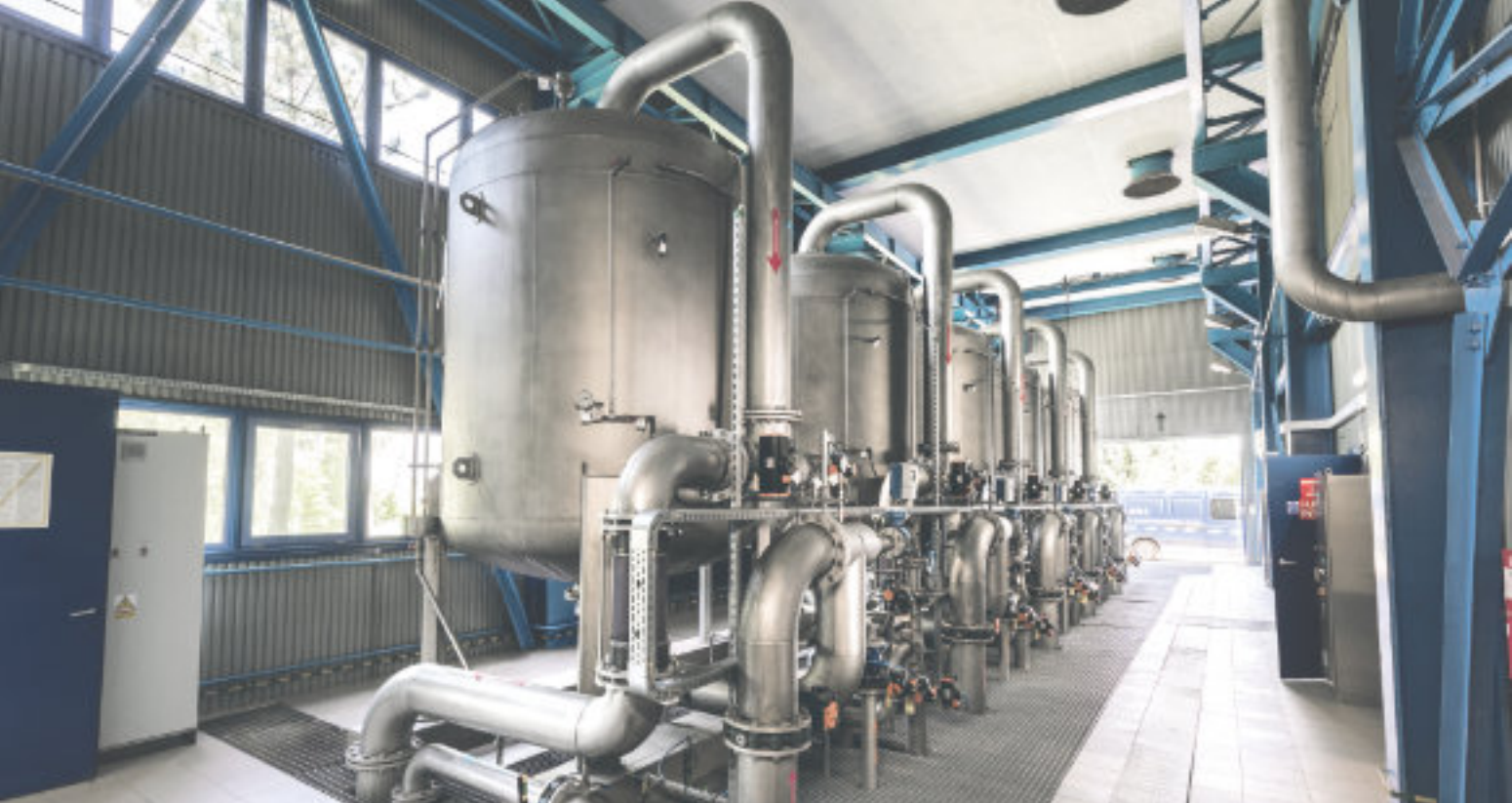
► Stacja Uzdatniania Wody Leśna w Mikulczycach Fot. ZPWIK
