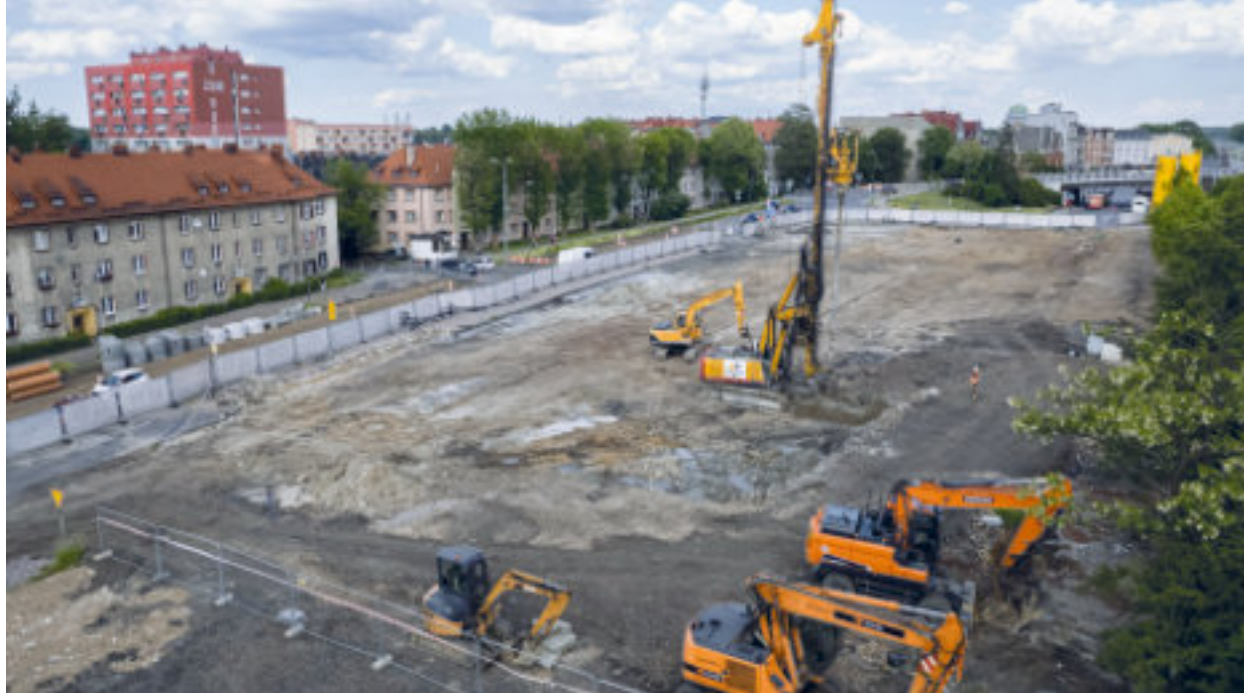
► Na placu budowy przy ul. Goethego pojawiła się ogromna palownica, która ma wykonać ponad 700 otworów Fot. UM Zabrze
