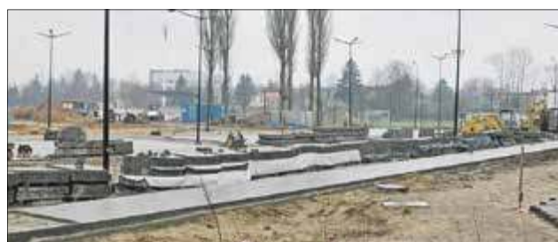
Parking miał być gotowy z końcem ubiegłego roku. Nadzór inwestorski nakazał jednak znaczące poprawki
