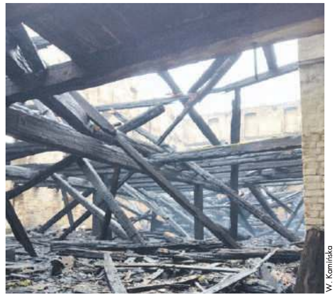
Spalił się dach i drewniana konstrukcja wewnątrz budynku
