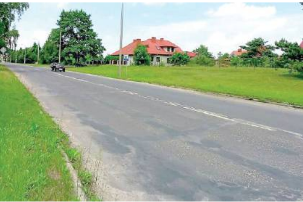
Droga jest obecnie w fatalnym stanie
