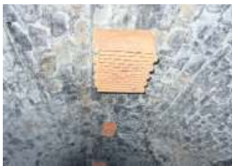
Takie budki lęgowe dla nietoperzy zawieszono w piwnicach pałacowych w Rachaniu.
