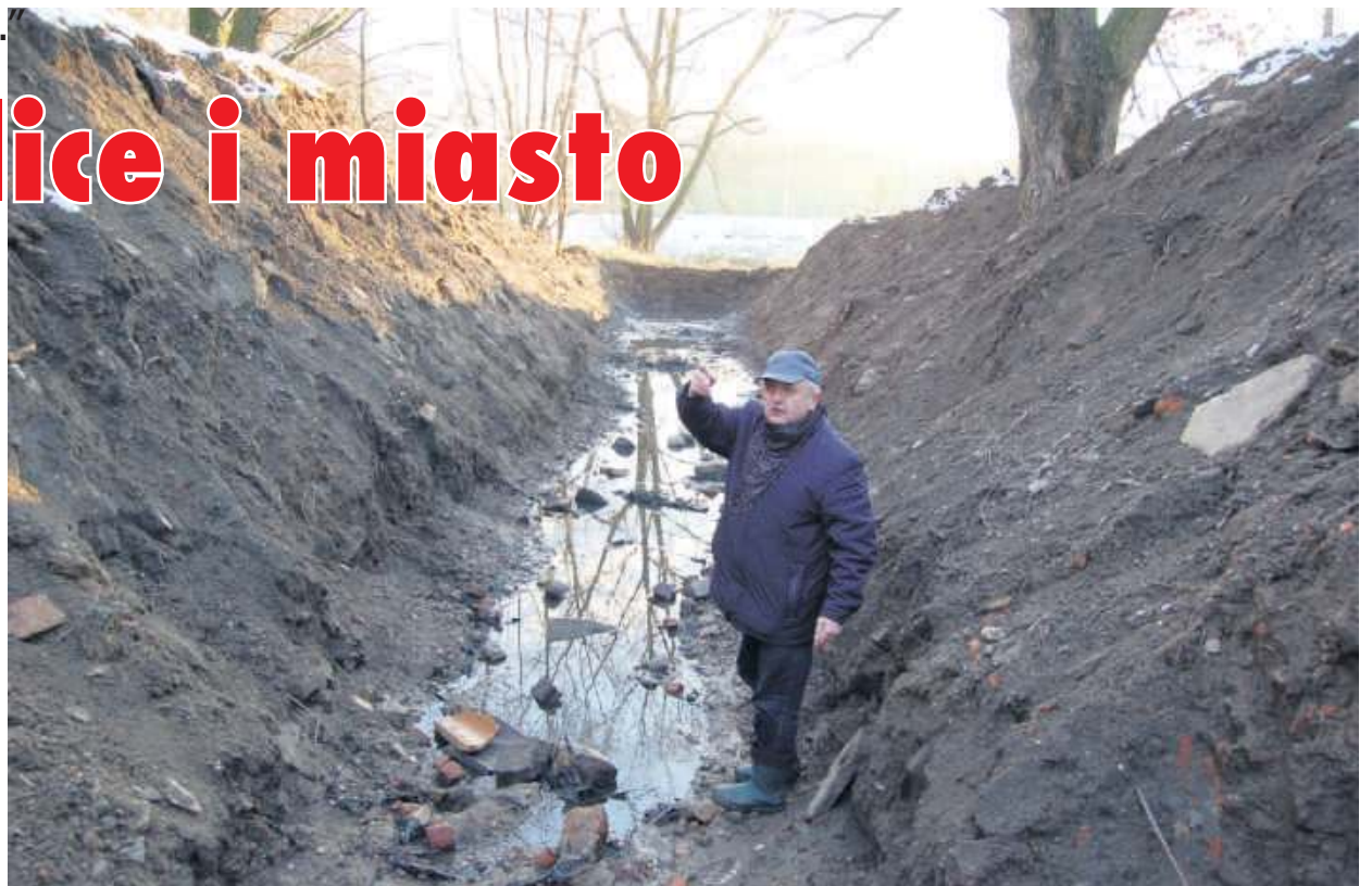
- Uciążliwości nie dotyczą tylko ul. Ks. S. Michałkiewicza, lecz też dużej części Strzelina - mówi były radny Julian Kaczmarek. Zdjęcie wykonano w miejscu, w którym wykopano dwa nieuszczelne kolektory deszczowe
