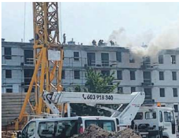
Podczas układania papy zapalił się dach w nowo budowanym bloku.
