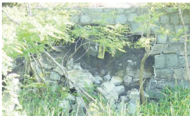
Zawaliło się kilka metrów kwadratowych ściany
