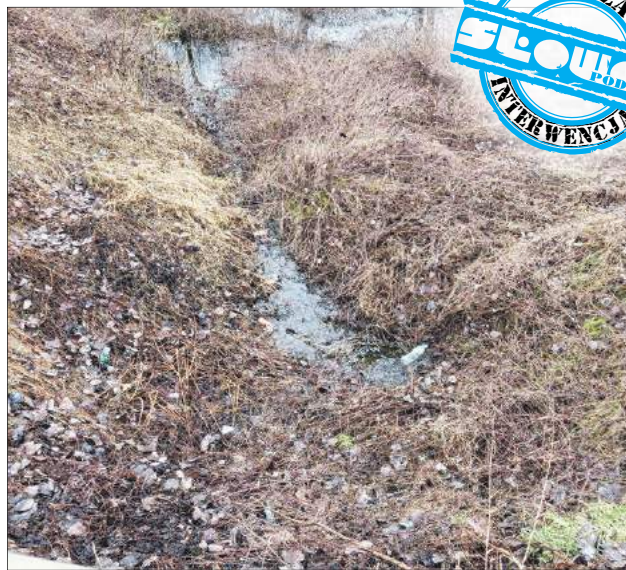
Zapchany rów melioracyjny zlokalizowany w okolicy ul. Wiejskiej w Terespole
