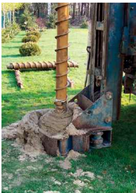
🔧 Wykonanie odwiertów pod sondy pionowe jest kosztowne i wymaga użycia specjalistycznego sprzętu. Jednak pod względem energetycznym to najlepsze źródło dolne, które ma stałą, wysoką temperaturę. NIBE-BIAWAR
