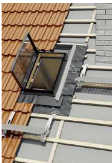
Wyłaz dachowy zapewnia wygodny dostęp do dachu kominarzowi, który wykonuje przegląd komina. OKPOL
