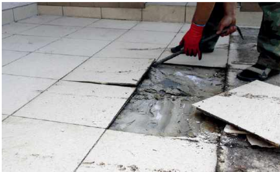
📍 W naszym klimacie, płytki niewłaściwie przyklejone do betonowej płyty odspoją się od niej po kilku zimach. J. WERNER
