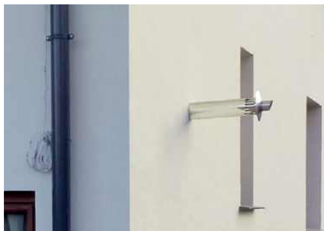
Przewód powietrzno-spalinowy, wykonany z dwóch współosiowych (koncentrycznych) rur, wyprowadza się z budynku najczęściej przez ścianę. CZ. DĄBROWSKI
