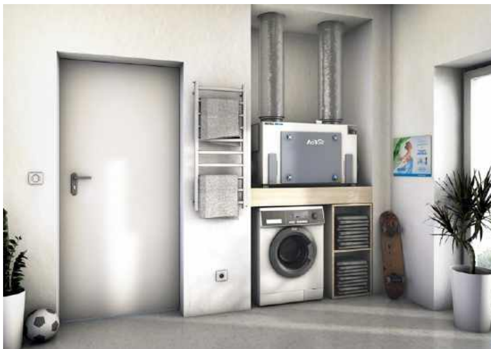
Centrała wentylacyjna, popularnie nazywana po prostu rekuperatorem, ma zapewnić kontrolowaną wymianę powietrza w całym domu. PRO-VENT
