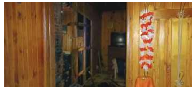
Dom wymaga gruntownego remontu
