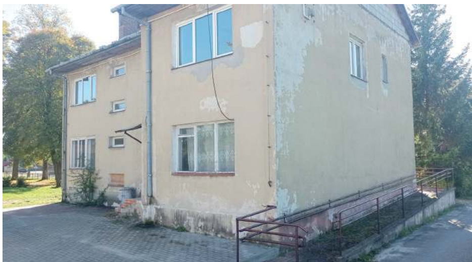
Budynek po byłym ośrodku zdrowia w Tereszpolu czeka gruntowny remont
