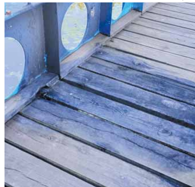
Ktoś podpalił mostek w Pniowcu
