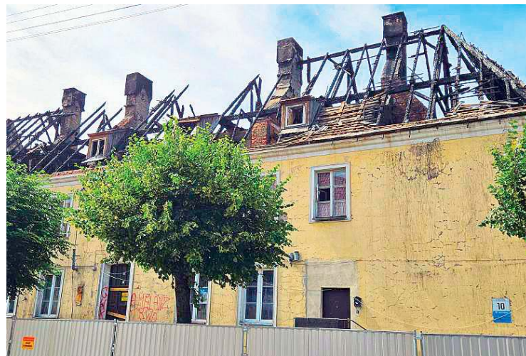
Spalony budynek przy ul. Słowackiego
