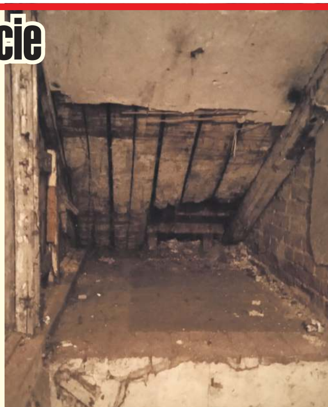
Stan techniczny schodów budzi niepokój mieszkanki
