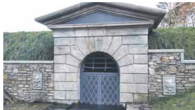
Już po tym jak Bramę Gwarków zrewitalizowano, uszkodzili ją wandal
