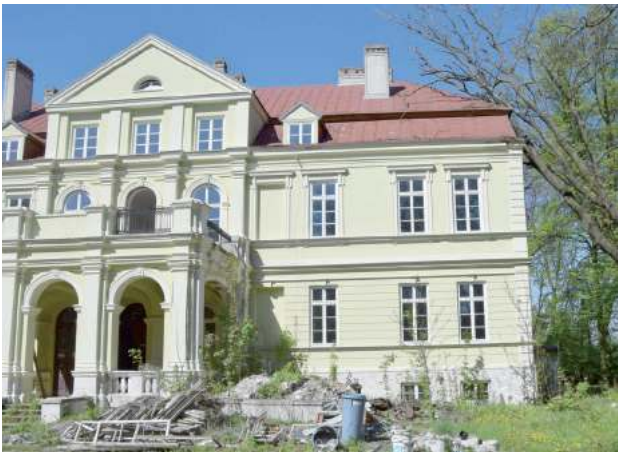
Nikt od jesieni nie zadał sobie trudu, by usunąć powalone na dach zabytku drzewo
