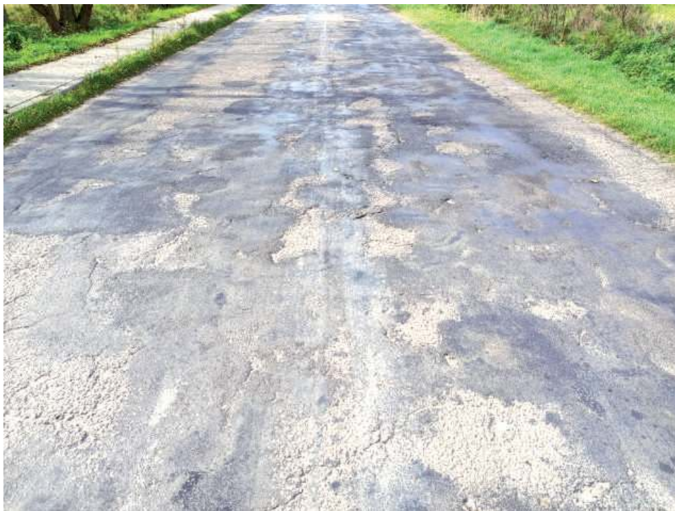
Tak aktualnie wygląda nawierzchnia drogi powiatowej biegnącej przez Łąkoć. Gołym okiem widać nierówności i liczne połatania ubytków
