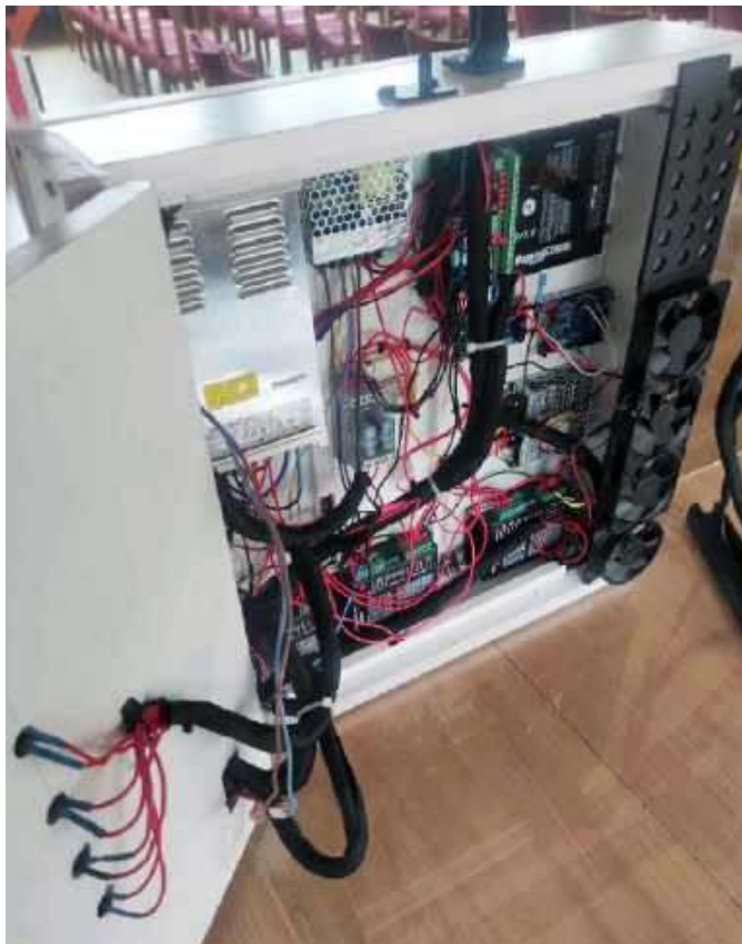
Fotografia 1. Szafa sterownicza robota
