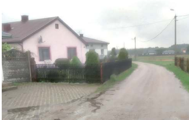
Równiarka wyrwała część kamieni na poboczu drogi przy remizo-swiecicy
