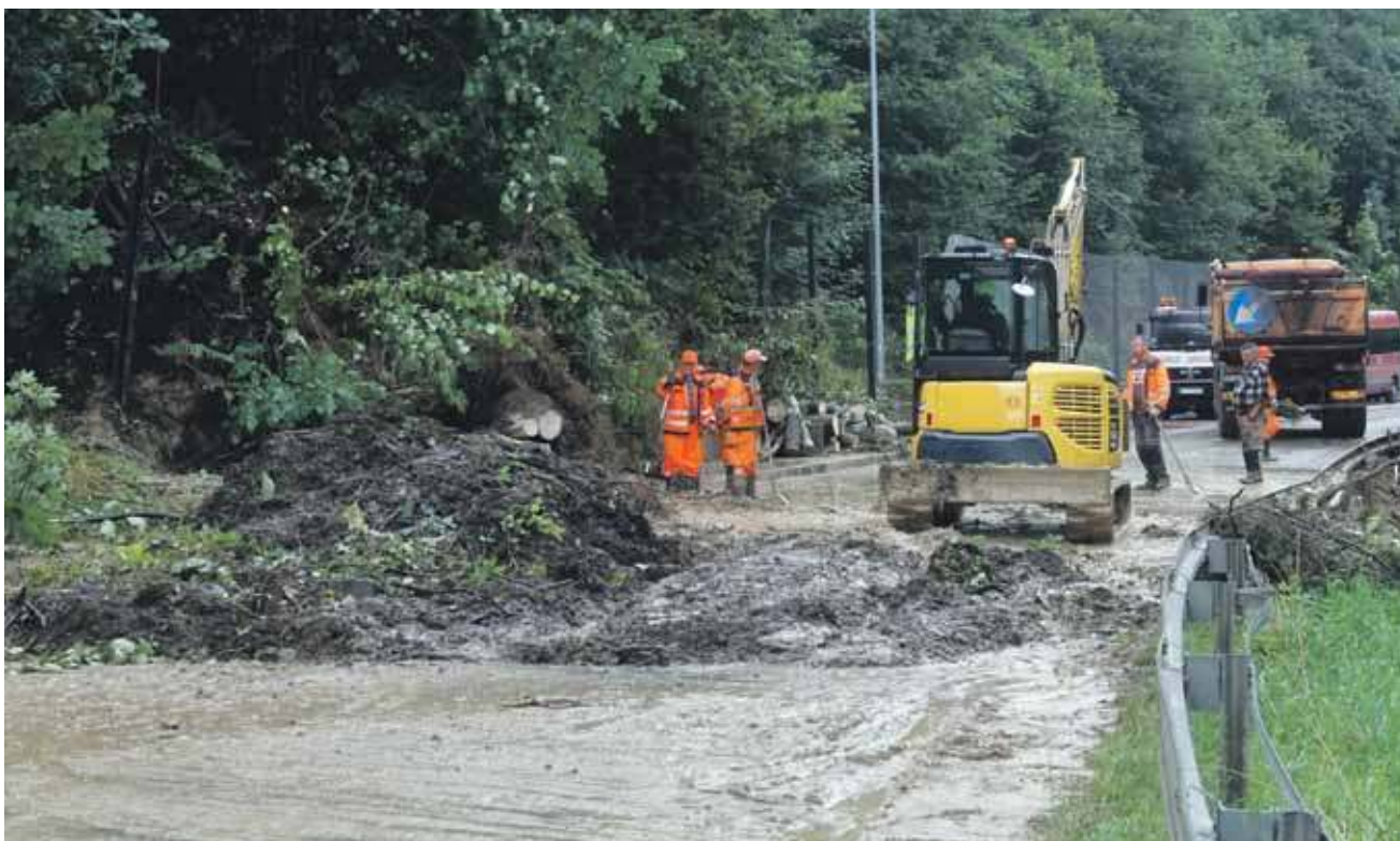
Zwały osuwającej się ziemi uszkodziły drogę i torowisko.
