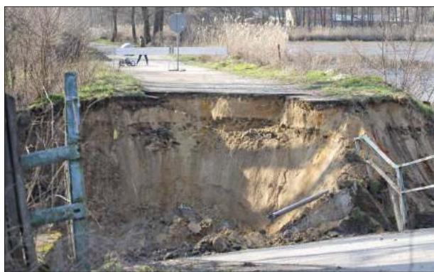
■ Most był wykonany z jednego żelbetowego elementu, a oba jego końce wsparte na nasypach. Prawdopodobnie woda podmyła ziemię i z jednej strony budowla runęła
