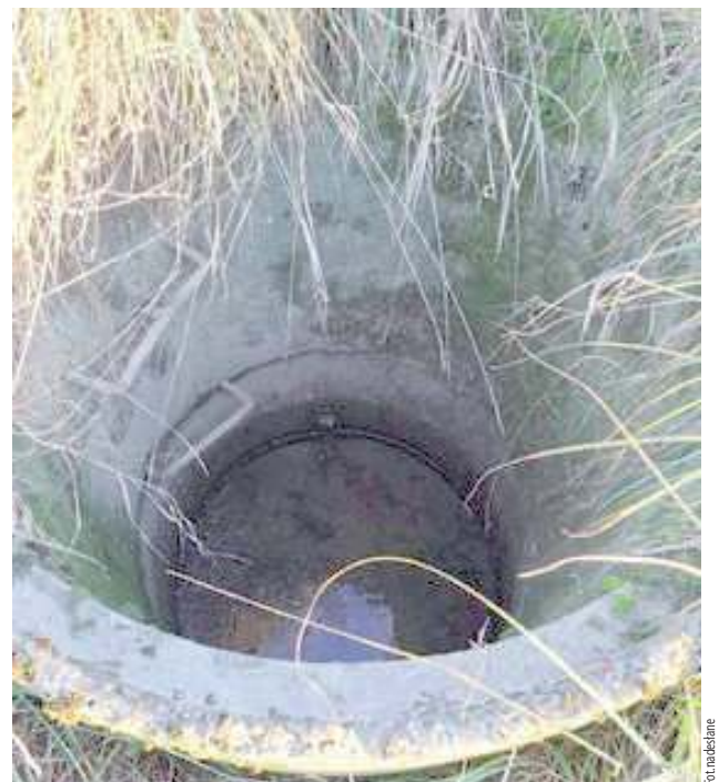
Niezabezpieczona i porośnięta trawą studnia melioracyjna znajdowała się w Przymiarkach (gm. Księżpol) w odległości 300-400 metrów od zabudowań (foto: listopad 2023)
