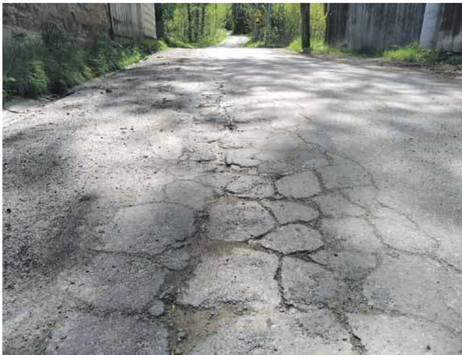
Droga nadaje się do całkowitej przebudowy.
