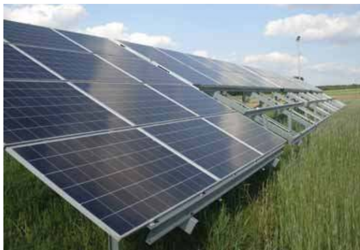
Farma fotowoltaiczna w Kowalewku. Luki na stelażu czekają na wypełnienie
