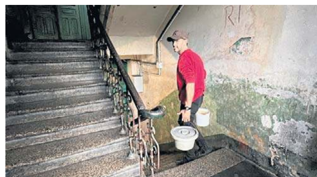
Pęknięta rura zamieniła podwórko w bagno z drewnianymi kładkami, po których wynosi się nieczystości...
