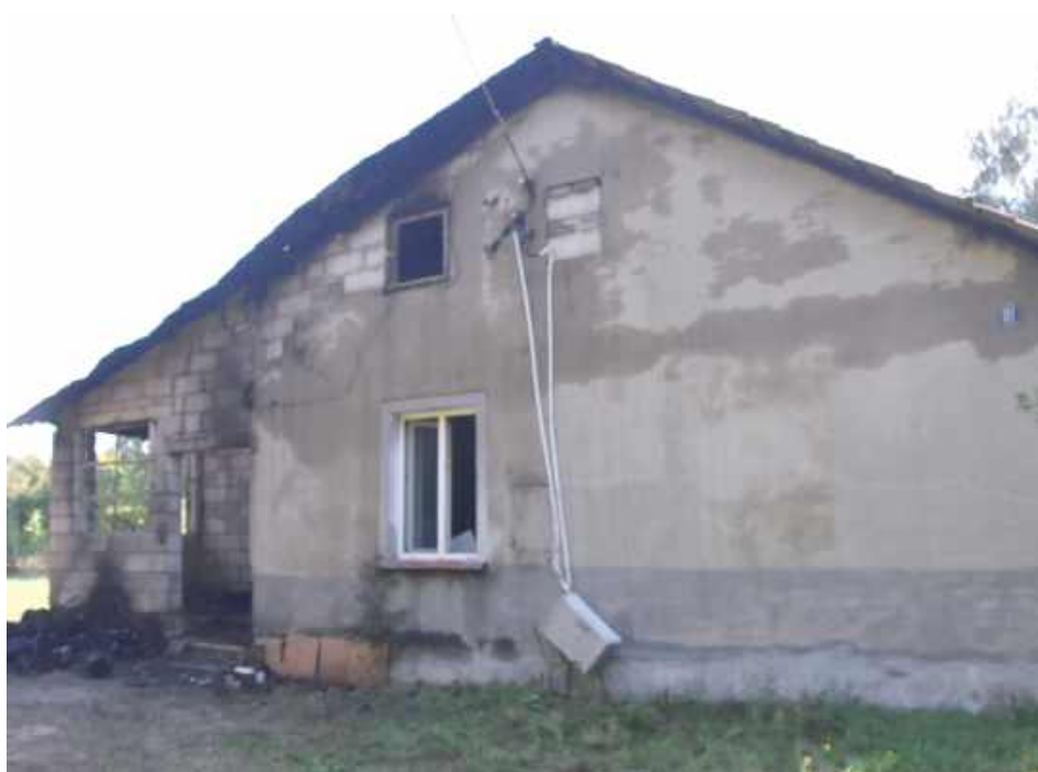
Jeden z podpalonych budynków. Podpalaczom grozi kara do 5 lat pozbawienia wolności
