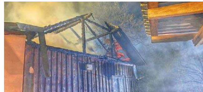
Ogień zniszczył część konstrukcji domu oraz instalacje
