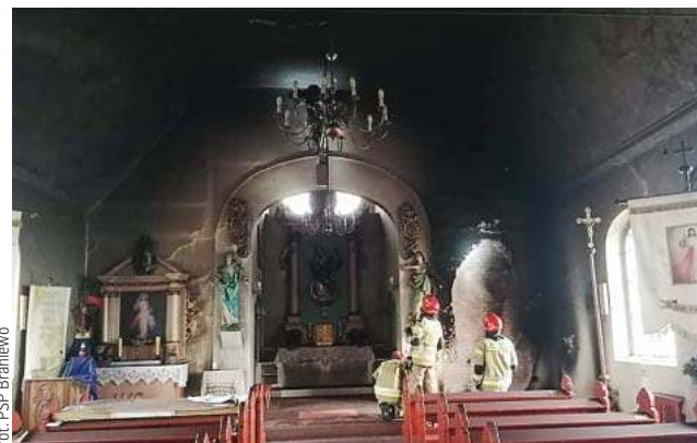
Tak wyglądało wnętrze kościoła zaraz po pożarze
