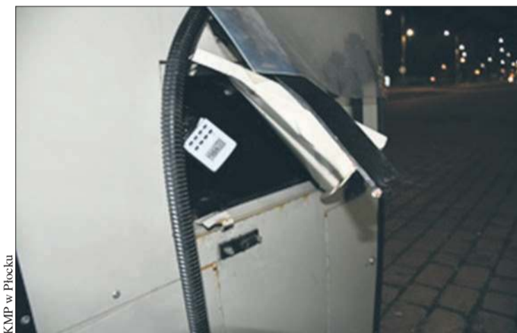
Uszkodzony przez złodziei automat przy ul. Tysiąclecia
