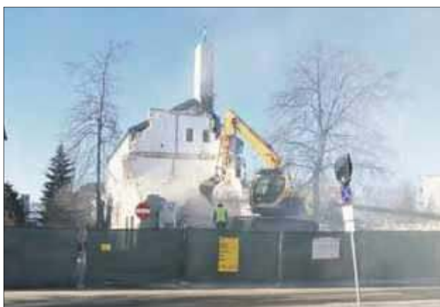
W poniedziałek, 14 lutego rano po kamienicy niewiele już zostało
