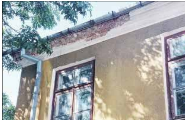
Z kamienicy przy ul. Pocztowej 2 obsypuje się gzysms, co zagraża bezpieczeństwu najemców i klientów lokali
